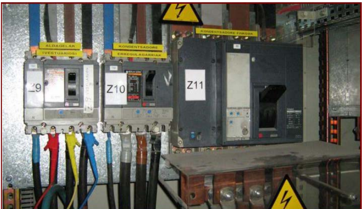
Figura 6. Pinzas voltímetras mordiendo el correspondiente conductor desnudo.
