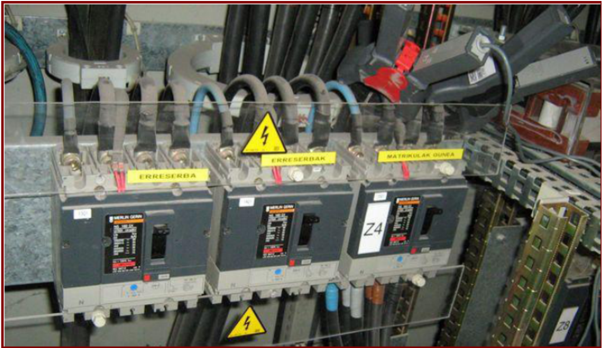
Figura 5. Pinzas amperimétricas abrazando los correspondiente conductores
